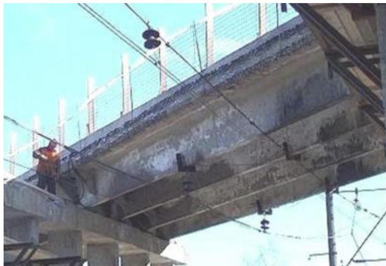
Рисунок 1.6 – Разрушение бетона конструкций пролетного строения моста
